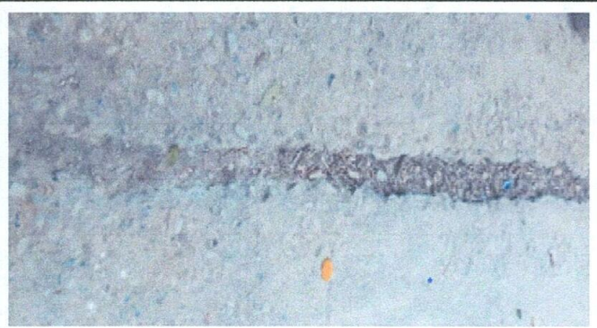
Foto2. Grietas por movimientos sismicos.
