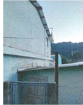
Foto 8: Red de agua potable
