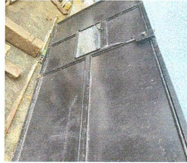
Foto 2: Puertas de metal
