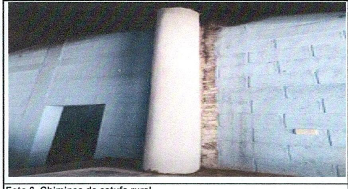
Foto 6. Chimenea de estufa rural
