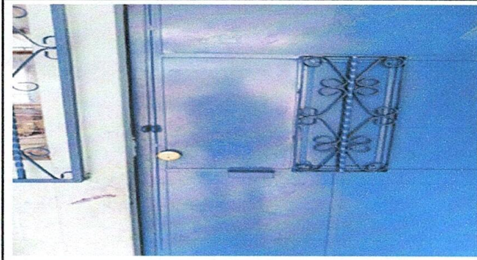
Foto 7. Tablero de plifones, planta baja
