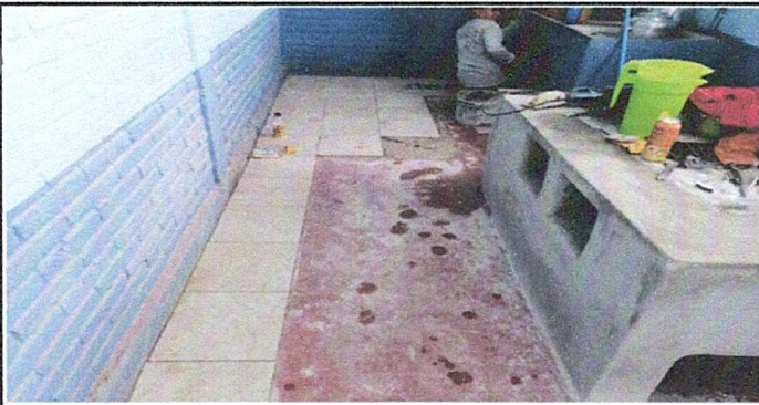
Foto 11. Piso cerámico en cocina
