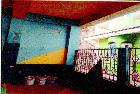
Foto 1: Pintura de pared y cielo de terraza en mal estado
