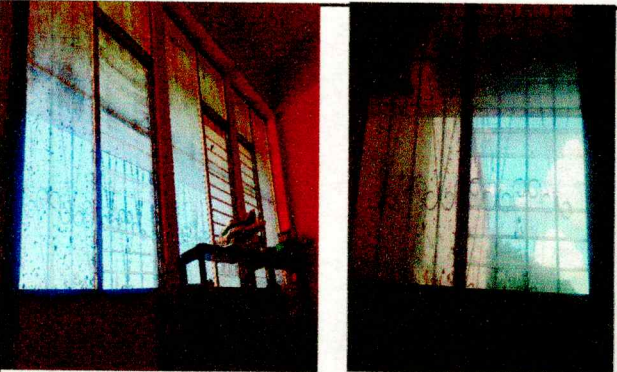
Foto 3: Ventana, Cambiar por PVC y vidrios
