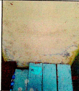
Foto 2: Pintura en mal estado de cielo de terraza
