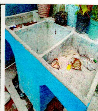
Foto 6: Pila en mal estado
