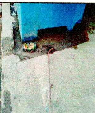
Foto 5: Drenaje en mal estado
