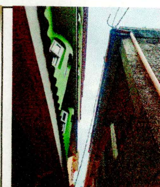
Foto 4: bajada pluvial en mal estado
