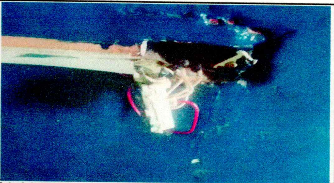
Foto 4: tomacorrientes en mal estado y quebrados
