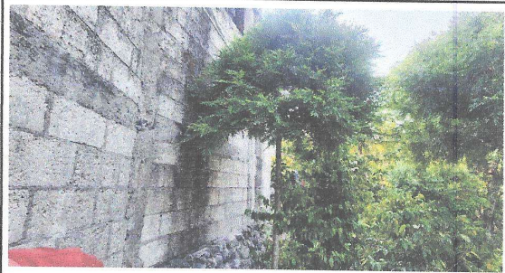
Foto 10: Vista de la parte afuera del muro de contención, necesaria remozarla para seguridad de niños y docentes.
