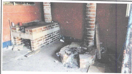
Foto 6: Vista de la cocina en mal estado.
