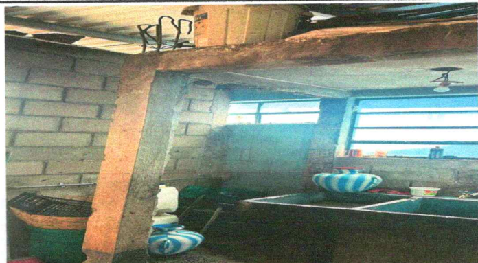
Foto 2: REPARACIÓN DE REPELLO Y CERNIDO EN PAREDES DE MODULO DE PRIMARIA DE ALDEA EL GRANADILLO
