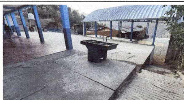
Foto 9: Área enfrente de cocina el cual se colocara techo, en época de lluvia no se pueden lavar utensilios.
