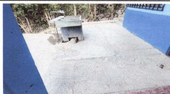
Foto 8: Área enfrente de cocina el cual se colocara techo, en época de lluvia no se pueden lavar utensilios.
