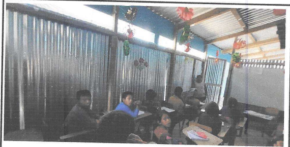
Foto 10: Se observa el estado actual de las aulas, espacios no idóneos para el aprendizaje.
