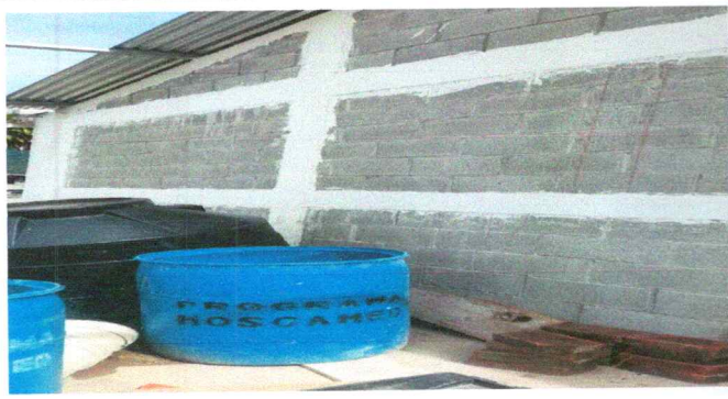
Foto 3: PINTURA EN PAREDES DE AULAS DE SEGUNDO NIVEL EN MODULO DE PRE-PRIMARIA DE ALDEA EL GRANADILLO
