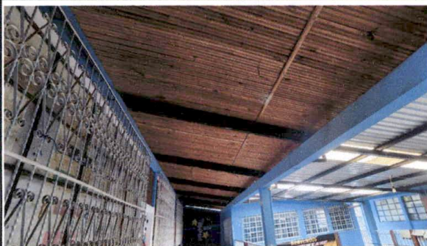
Foto 3: Vista interior del pasillo modulo 2, se observa el mal estado del machimbre debido a las filtraciones de la cubierta de lamina.
