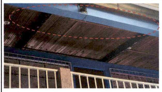
Foto 4: Vista interior del pasillo modulo 2, se observa el canal, el cual al llover no se da abasto para desfogar el agua pluvial.
