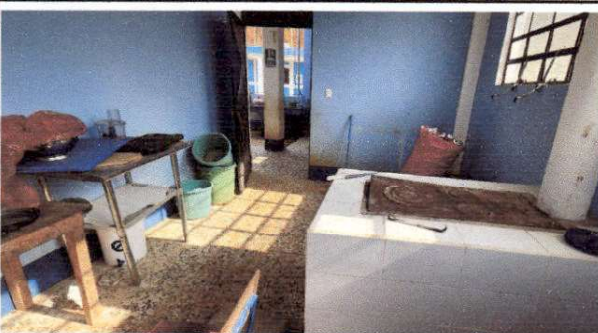
Foto 5: Vista del interior de la cocina, la estufa existente no funciona y el piso está en mal estado.
