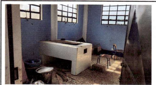
Foto 6: Vista del interior de la cocina, la estufa existente no funciona y el piso está en mal estado.
