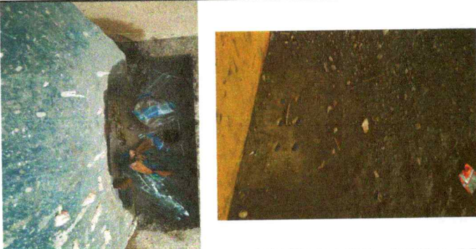
Foto 11: REPOSADERAS EN MAL ESTADO
