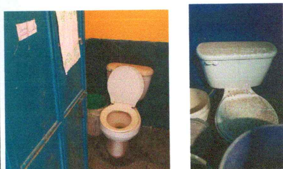
Foto 2: SANITARIOS EN MAL ESTADO
