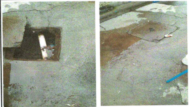
Foto 12: CAJA DE REGISTRO EN MAL ESTADO
