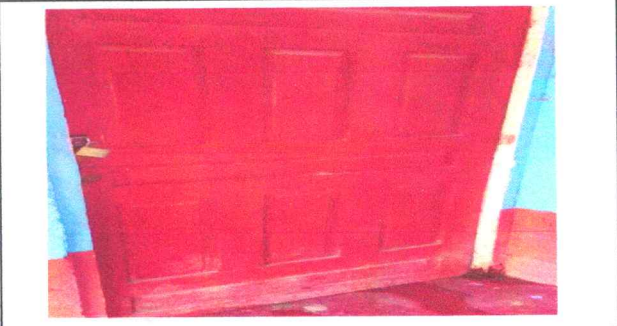
Foto 8: SUSTITUCION DE PUERTAS DE MADERA POR METAL EN MODULOS DE INEB ALDEA EL GRANADILLO
