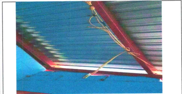
Foto 7: REPARACION DE SISTEMA ELECTRICO EN MODULO DE INEB DE ALDEA EL GRANADILLO
