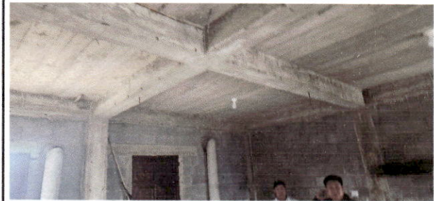
Foto 6: Vista de losa, se aplicará repello para remozarla.
