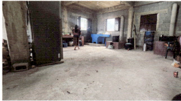
Foto 7: Se Observa el piso, se remozara colocando piso.
