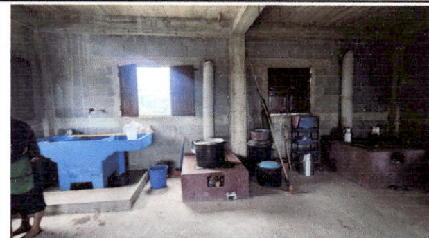
Foto 11: vista del interior de la cocina es necesario realizar una remozamiento.
