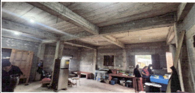
Foto 5: Vista interior de cocina se observa el block Visto y cielo sin ningún.
