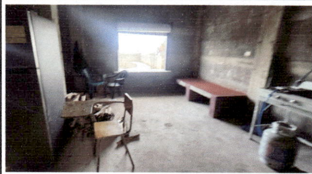
Foto 10: vista del interior de la cocina es necesario realizar una remozamiento.
