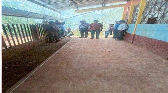
Foto 1: piso de concreto del corredor del centro educativo en mal estado
