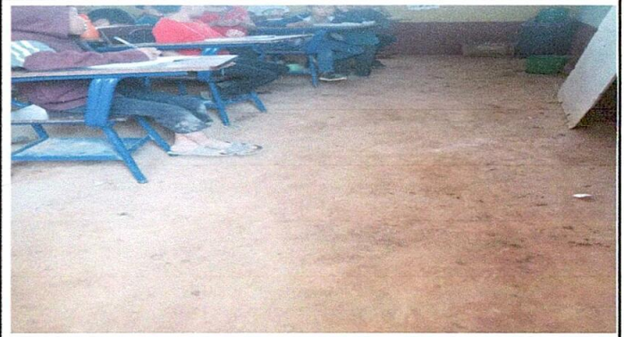
Foto 2: piso de concreto de aulas en mal estado
