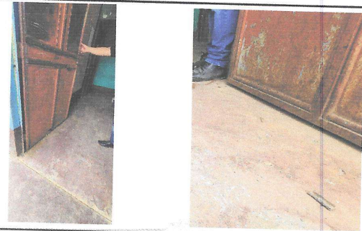
Foto 10: se observa la puerta en mal estado.
