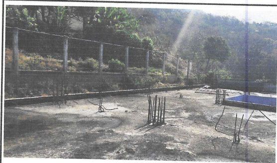
Foto 10: Vista del muro perimetral, en el cual se levantará pared con soleras de refuerzo.
