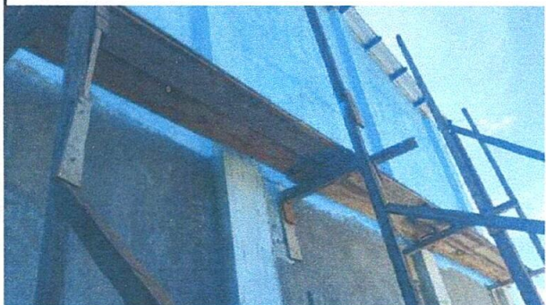
Foto 1: Reflejo de la pintada de los paredes
