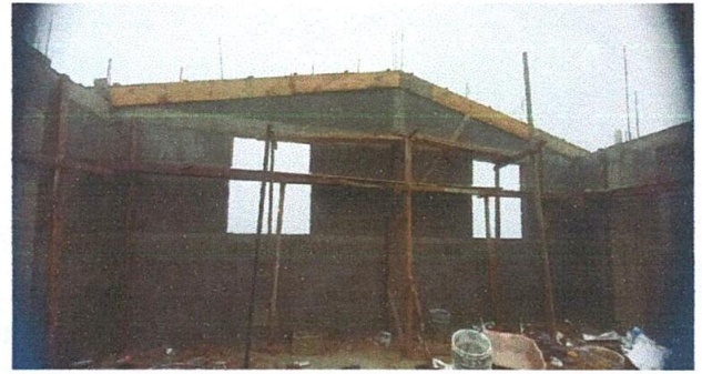
Foto 4: mejoramiento de paredes para colocar y mejorar techo de lamina troquelada calibre 26.
