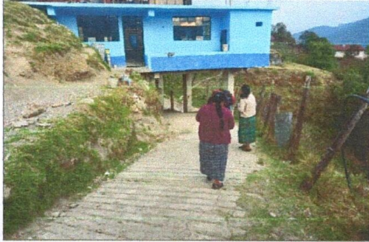
Foto 1: Sustitución y colocación de muro de contension, ya que los estudiantes corrien riego en la entrada del aula.
