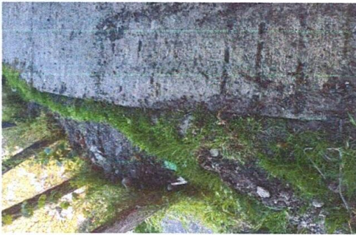
Foto 3: Calle de acceso del centro educativo en riesgo de colapso.
