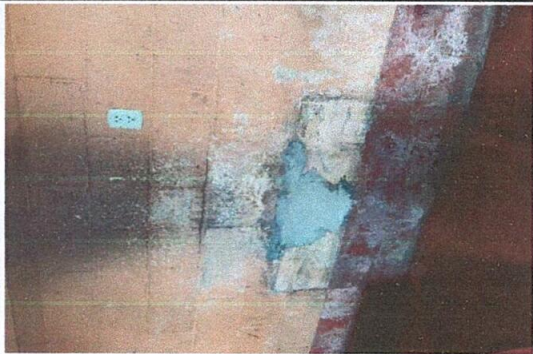
Foto 3: Las paredes de la cocina se necesitan mejorar y sustitución de piso de concreto por piso ceramico.
