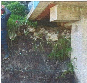
Foto 5: La entrada del aula en riesgo de derrumbar
