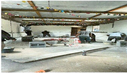
Foto 9: las paredes necesitan repello para evitar filtración y humedad.
