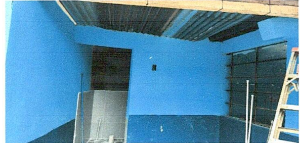
Foto 8: Remodelación de ventanas viejas donde deja entrar agua y polvo.
