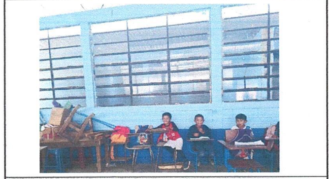
2. Aquí se puede ver que los trabajos de mantenimiento de ventanas, cambio de vidrios rotos y cambio de vidrios transparentes a nevados están finalizados.
