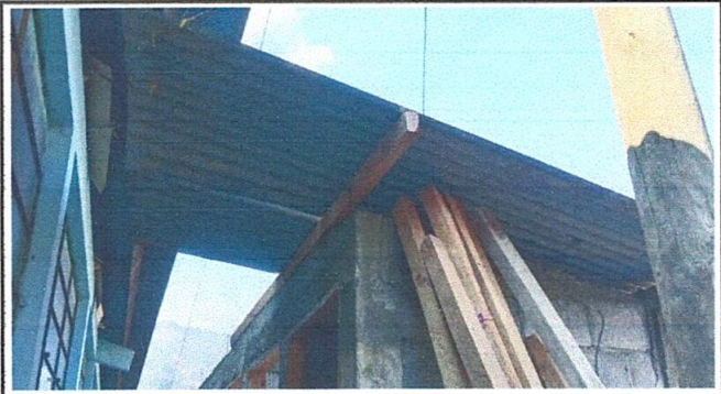
Foto 4: En la fotografía se observa la falta de láminas en las instalaciones de los baños, las cuales están picadas por lo que se cambiará lamina por lámina aluzinc.
