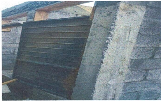
3. En la fotografía se observa la puerta en malas condiciones al cual se cambiara por puertas de metal en servicios sanitarios.
