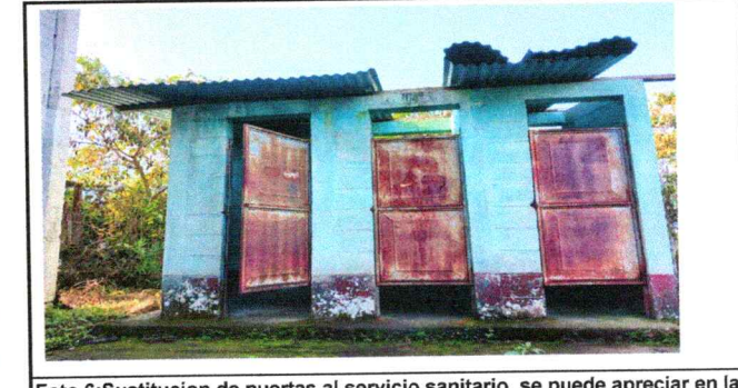
Foto 6: Sustitución de puertas al servicio sanitario, se puede apreciar en la fotografía que este servicio está en malas condiciones las puertas agrietadas y disfuncionales.
