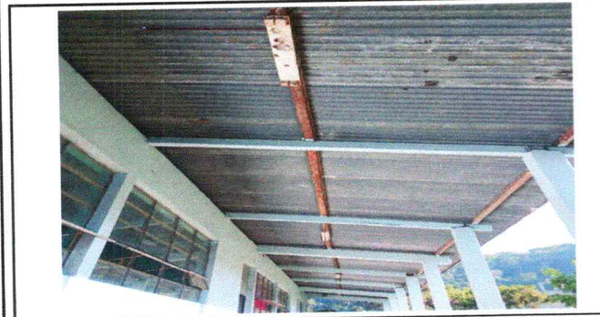
Foto 3: sustitución de estructura de madera por estructura de metal, es necesario cambiar las reglas y tijeras que sostiene el techo, porque ya están desgastados y picados por el agua que ingresa de la lámina y el capote
