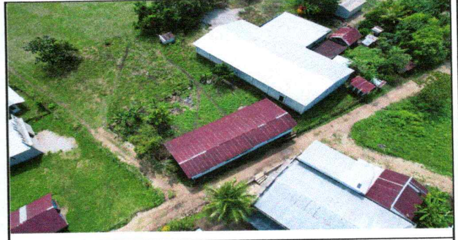
Foto 2: sustitución de capote de lámina ,por lámina troquelada, en la imagen se puede observar que los capotes están desgastados y corren peligro en hundirse hacia adentro de las aulas
