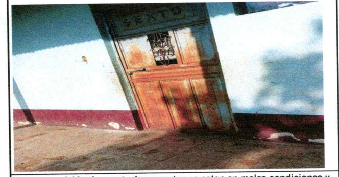
Foto 4: sustitución de puerta. Las puertas ya están en malas condiciones y agrietadas por el paso del tiempo
