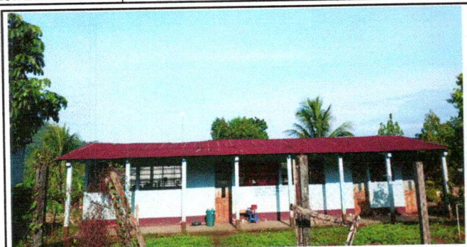
Foto 1: Sustitución de Lámina ,por lamina troquelada aluzinc, se puede observar que las laminas que la escuela tiene ,ya tiene grietas y se llena de agua las aulas
