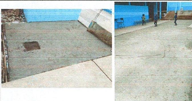
Foto 5: Piso de concreto mal ubicado
