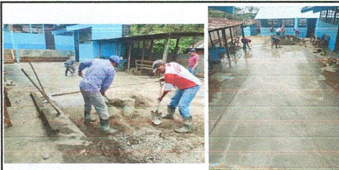
Foto 5: Piso de concreto mal ubicado
