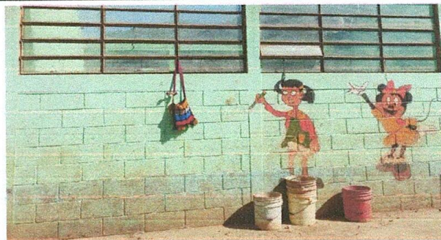
Foto 6: Pintura en malas condiciones.
