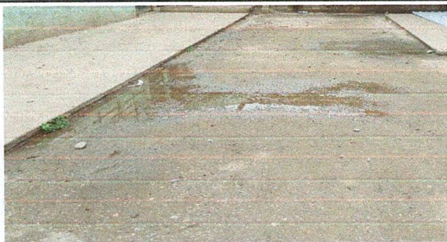
Foto 5: Piso de concreto mal ubicado
