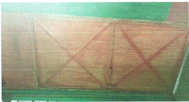
Foto 3: Puertas en malas condiciones
