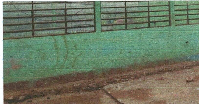
Foto 4: Pintura en malas condiciones
