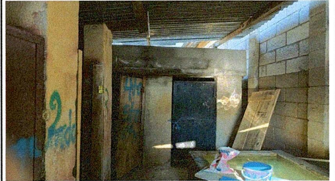
Foto 2: Los baños en mal estado
