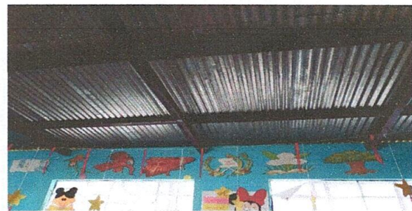
Foto 6: Las vigas de madera están en mal estado.
