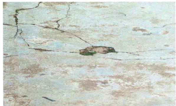
Foto10: Reparación de torta de cemento en malas condiciones
