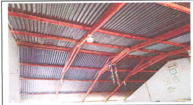
Foto1: Sustituir la madera por metal la dirección del establecimiento
