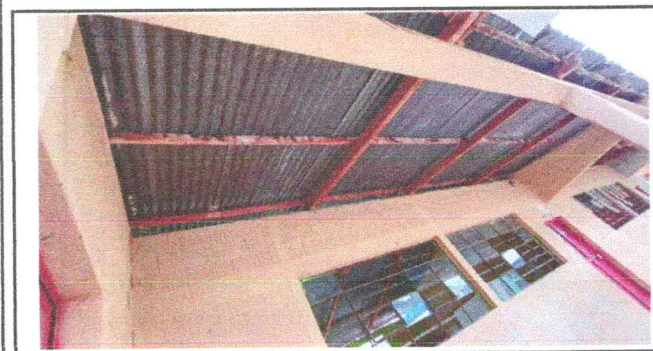
Foto 5: Estructura de madera en el corredor del establecimiento en mal estado.
