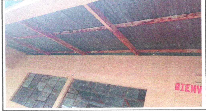
Foto 2: Sustituir la madera por metal el aula de tercero básico.
