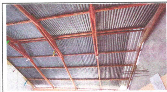
Foto 3: Sustituir la madera por metal el aula de segundo Básico
