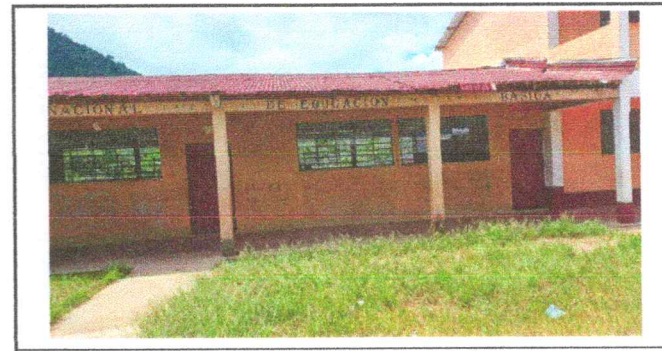
Foto 6: Vista en frente del establecimiento, con deterio de estructura de madera para sustituir a metal.
