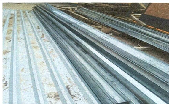
Foto 2: Ya están preparados los materiales para instalar la nueva estructura del techo
