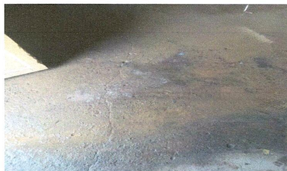
Foto 4: El piso de concreto tiene varias averturas por lo que es necesario repararla.
