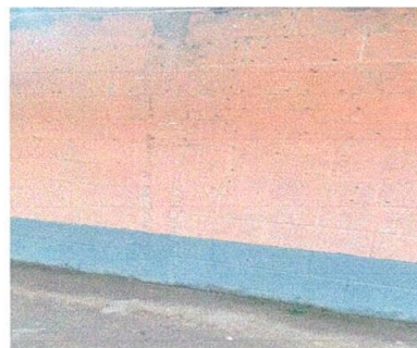
Foto 6: La pintura en la bodega y la cocina ya se encuentran muy manchadas y ya no se le ve bien el color.
