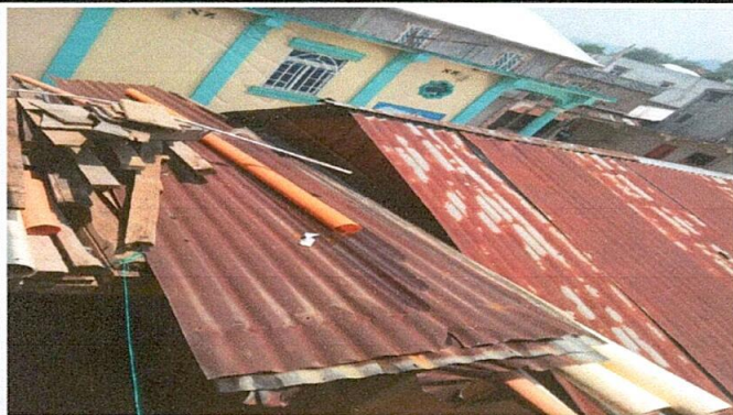
Foto 1: Las láminas se encuentran muy deterioradas.
