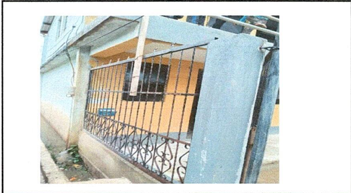
Foto1: Se va a sustituir la barda de metal por pared de block ya que representa un peligro para los niños, debido a que algunos niños se trepan en las bardas para llegar luego al segundo nivel.
