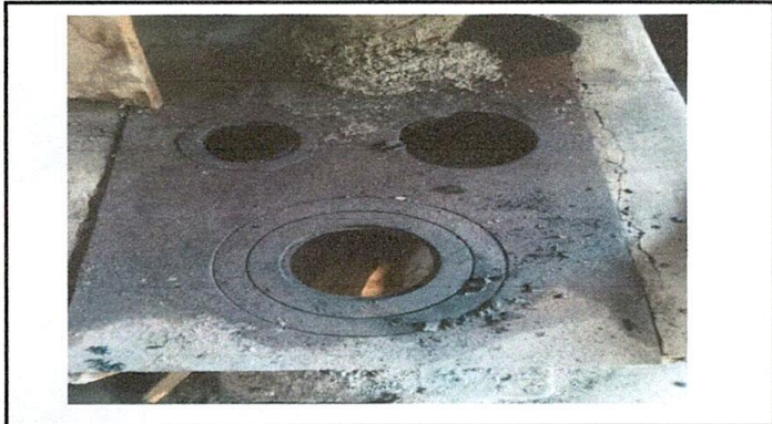
Foto 3: Se deberá cambiar la plancha por una nueva ya que está muy deteriorada.
