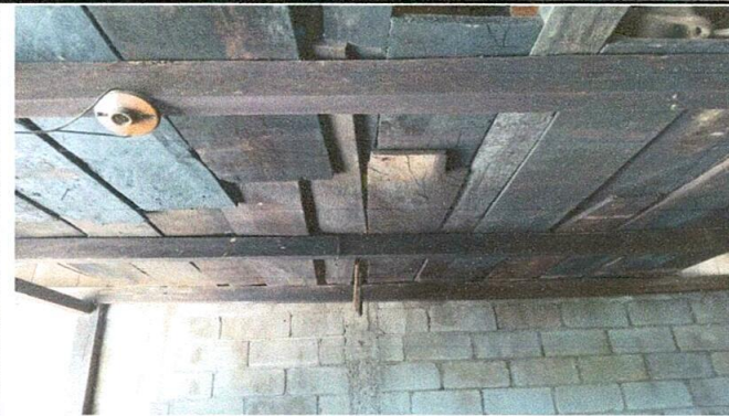
Foto 2: Para poder instalar nuevas láminas es necesario cambiar la estructura de techo de madera por metal
