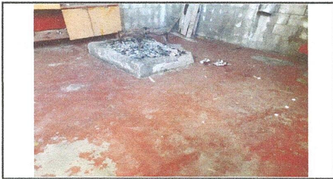
Foto 5: Piso en mal estado, en el cual se sustituirá torta de concreto y piso de cemento líquido.
