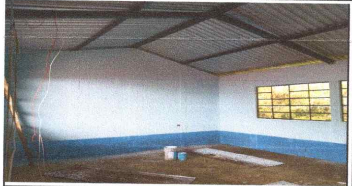
Foto 2: Mantenimiento a estructura de metal de techo, picaduras y corrosiones.
