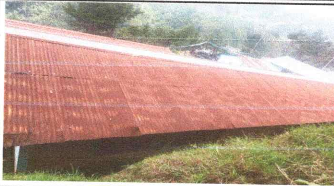
Foto 1: Sustrucción de lamina por laminas troqueladas aluzinc, por deterioro y picado.
