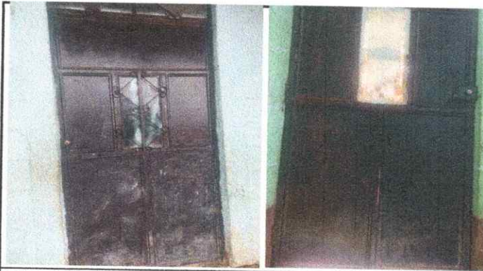
Foto 3: sustitución de puerta, puertas ya muy deterioradas y oxidadas.
