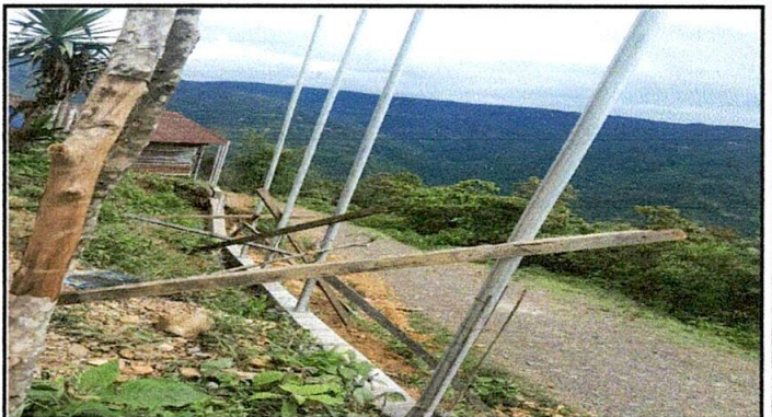
Foto 4: Reparación de muro perimetral de block con tubo hg y malla galvanizada, soleras intermedias y columnas en proceso.
