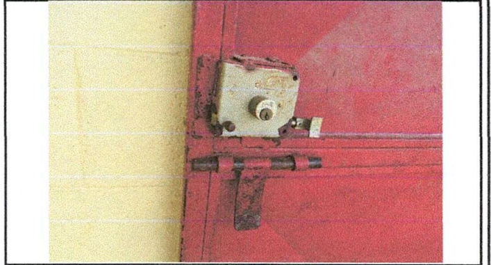
Foto 2: Puertas y chapa en mal estado.
