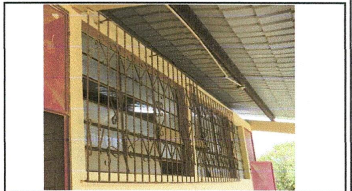
Foto 4: Balcones en mal estado.
