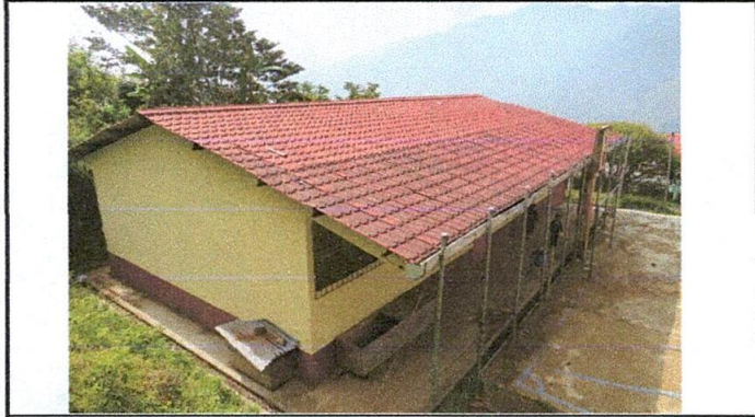
Foto 1: Lamina y estructura de soporte en mal estado.
