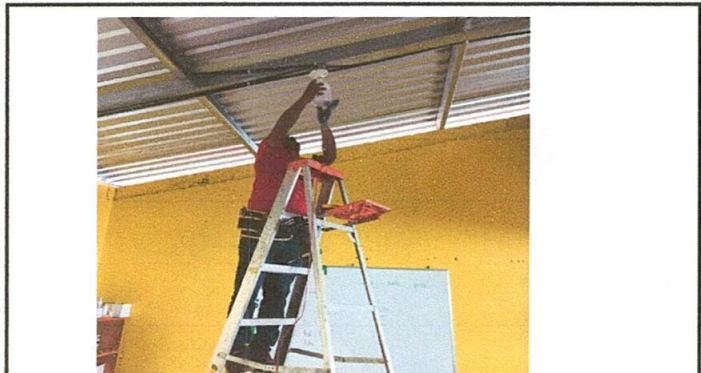
Foto 12: Sustitucion de lamparas tipo led
