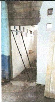
Foto 5: Puertas de la cocina ya quitadas por mal estado.
