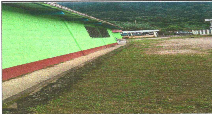
Foto 3: Cuneta de los modulos actuales
