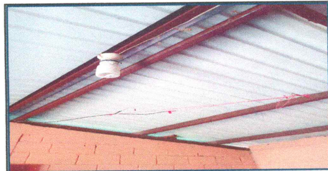
Foto 12: reapaición del sistema eléctrico
