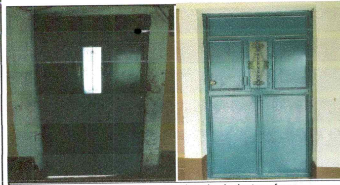
Foto 7 y 8: Puerta de metal de cocina vista desde dentro y fuera.
