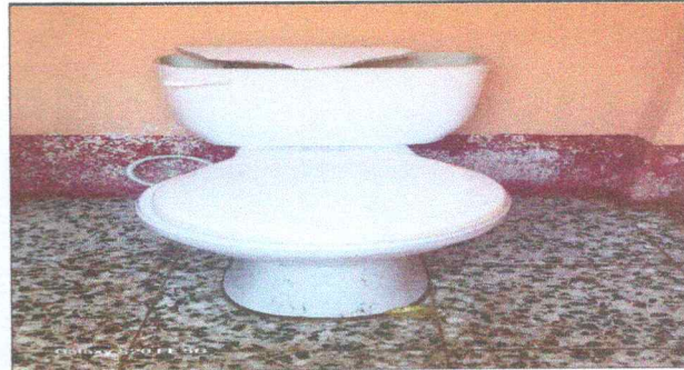
Foto 2: Servicios Sanitarios y sus accesorios en malas condiciones
