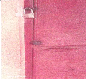
Foto 7: Sustrucción de chapa
