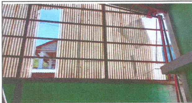
Foto 3: LÁMINAS TRANSPARENTES EN VENTANAS QUEBRADAS
