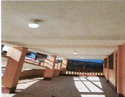
Foto 1: sustitución de bombillas ahorradoras
