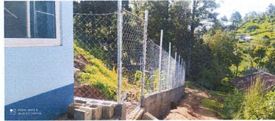
Foto 14: Reparación de muro perimetral de block con tubo hg y malla galvanizada
