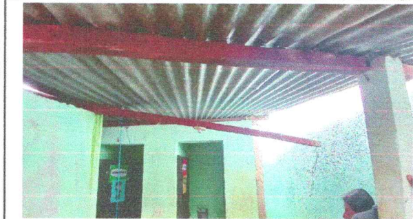
Foto7: Sustitución techo de baños:láminas acanaladas y vigas de madera por estructura metálicas (costaneras) con láminas acanaladas calibre 26
