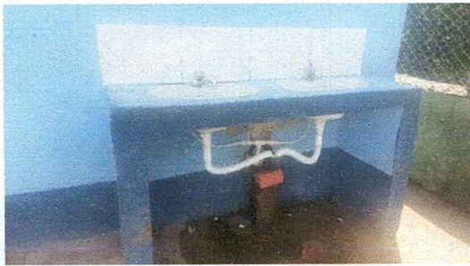
FOTO 3: Sustitución de accesorios de lavamanos en módulo de baños. (Se instalarán tubos flexibles, para asegurar el drenaje)
