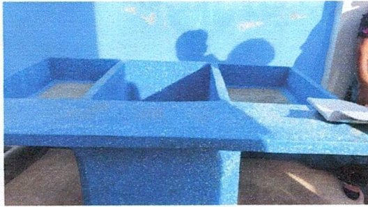
FOTO 1: Sustitución de pila de cemento, con tanque y 2 lavaderos. (se evidencia la falta de tanque y lavaderos adecuados)
